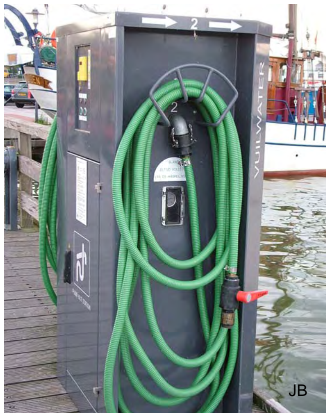
Een uitpompstation op de Gependam in Enkhuzen
